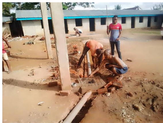
Regenwaterput en watervoorziening voor schoolcampus in Lodja - Congo (Ekimanyelo)
